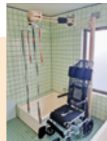
[導入したリフト浴設備]
